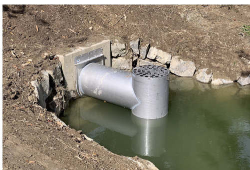
Montierter BPAO beim Beckenauslauf
