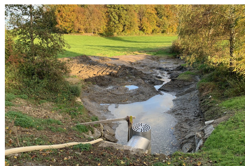
Schlammablagerungen im Becken
